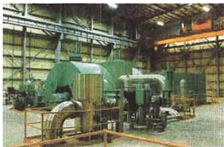
図2 地熱タービンの例 ニュージーランド、ナ・アワ・ブルア地熱発電所 (出力13.9万kW)。提供：富士電機
