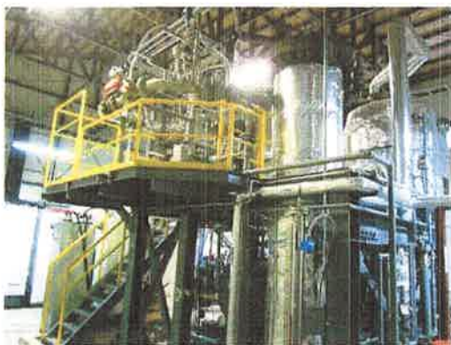
図2 松之山発電施設
